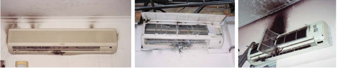
Şekil 2. Yangın olan bazı iç üniteler
