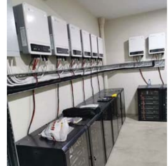
10 ADET GOODWE ET SERİSİ HİBRİT İNVERTÖRLERDEN OLUŞAN GANA'DAKİ 100KW GÜNEŞ ENERJİSİ DEPOLAMA SİSTEMİ
