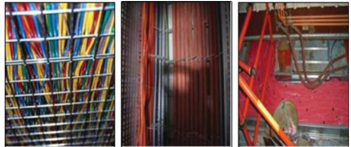
Kabloların yoğun bir şekilde gruplanarak bina içinde döşenmesi
